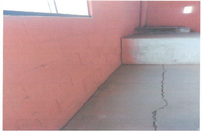
Foto 6: VISTA DEL MAL ESTADO DEL PISO EN EL AREA DE COCINA
