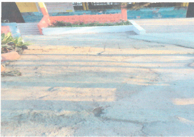
Foto 9: EN EL PATIO SE OBSERVA QUE LA TORTA DE CONCRETO INSTALADA SE HA REALIZADO CON RESTANTES DE MATERIALES Y SE ENCUENTRA CON FISURAS
