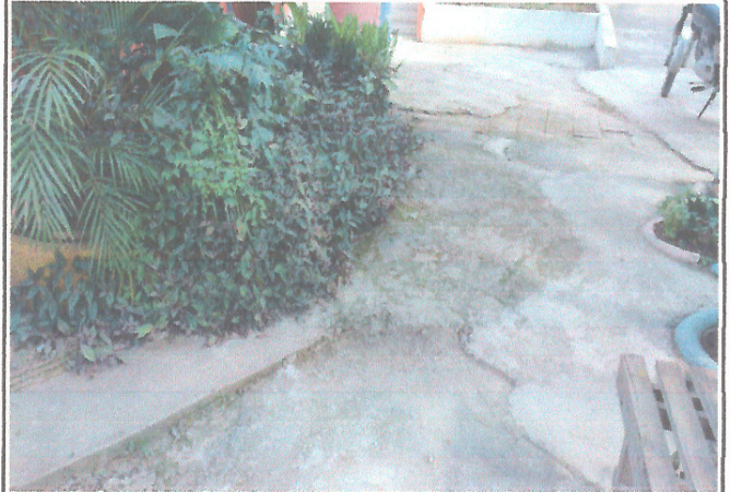
Foto 10: El piso se encuentra con fisura por lo que es necesario el cambio.
